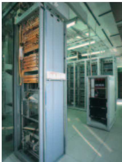
Abb. 18 ADSL-Einrichtungen werden im Telefon- wählamt installiert
