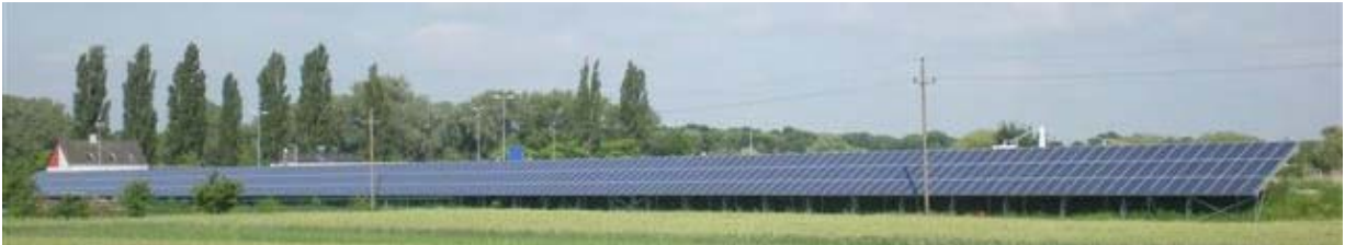
Abbildung 6: Foto der PV-Anlage des Abwasserverbandes Laaer Becken (Foto Gf. Muck)
