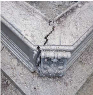
Bruch der Plinte im Zustand vor der Restaurierung (links) Armierung mit Edelstahl (rechts)
